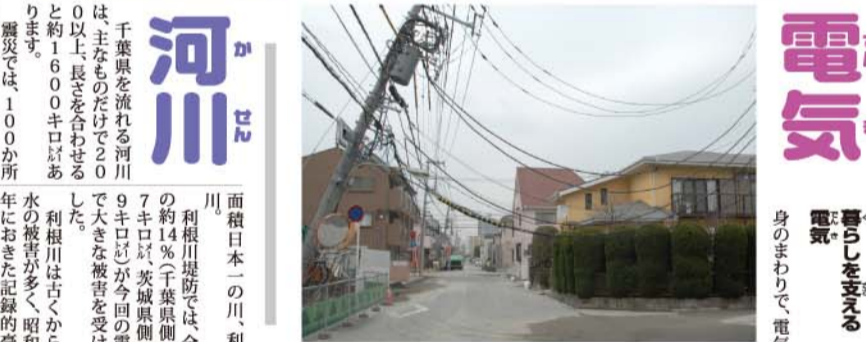
震災で傾き、倒壊寸前の電柱（浦安市提供）
