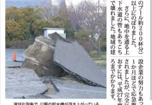
液状化現象で、公園の貯水タンクが浮き上がっている（浦安市提供）
